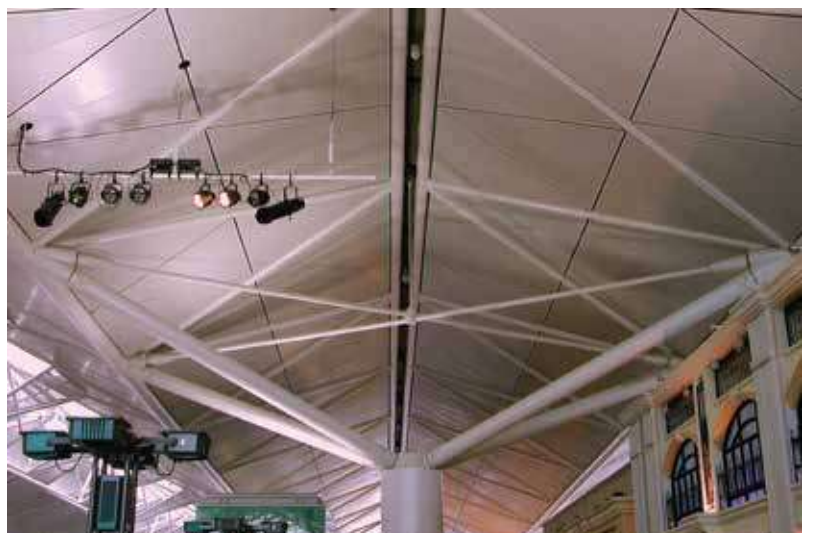
ブレースケーブル [愛知県 中部国際空港]
