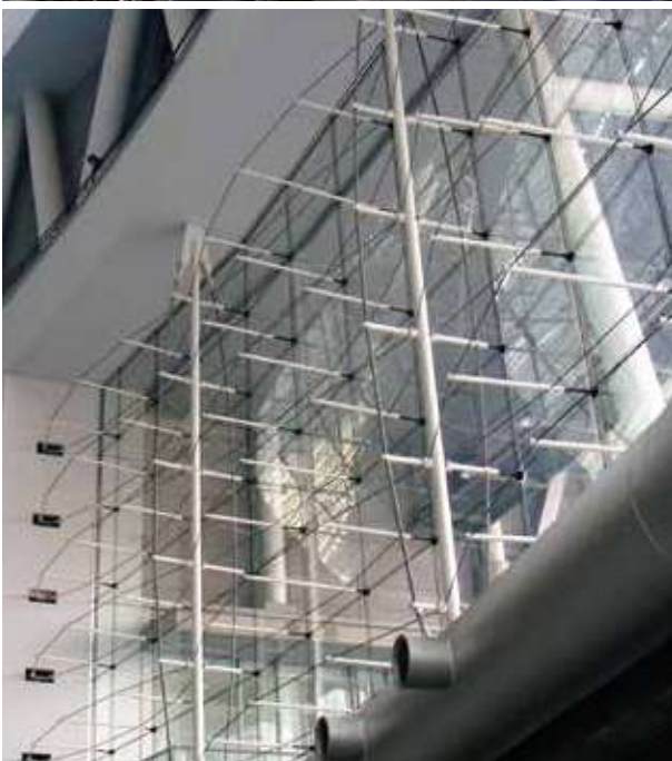
ガラス壁補強ケーブル [埼玉県 さいたまスーパーアリーナ]
